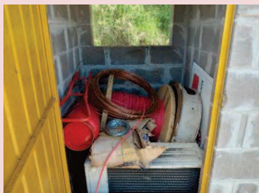
Foto 5-19. Vista interna de um dos compartimentos (Metal).
