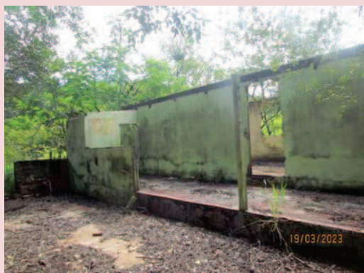
Foto 5-13. Vista da casa abandonada situada no Sítio Santa Rita, próxima da estrada onde está ocorrendo a erosão.
