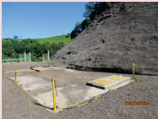
Foto 5-33. Sistema separador água e óleo (Caixa SAO) na área externa da casa de força da PCH Cantú 2.
