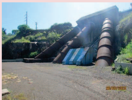
Foto 5-6. Vista do sistema externo da casa de força da PCH.
