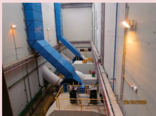
Foto 5-5. Vista interna da casa de Força da PCH Cantú 2.
