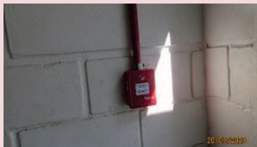
Foto 5-10. Sistema de alerta contra incêndio no interior da casa de força da PCH.
