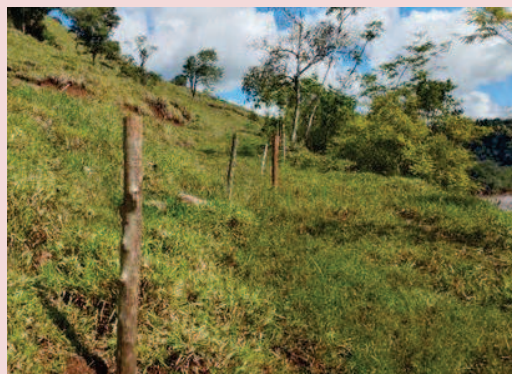
Foto 5-10. Instalação de cerca na APP em processo erosivo na M.E. do reservatório.
