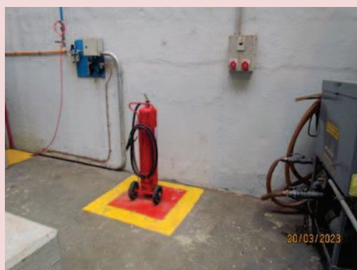
Foto 5-8. Disposição de um extintor na área interna da casa de força da PCH Cantú 2.
