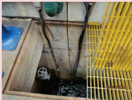
Foto 5-32. Grade com acesso para a caixa SAO na área interna da casa de força da PCH Cantú 2.
