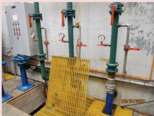
Foto 5-31. Sistema separador água e óleo (Caixa SAO) na área interna da casa de força da PCH.
