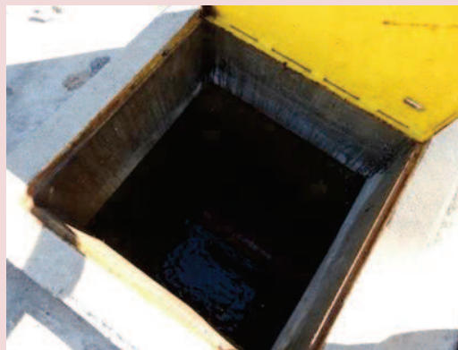
Foto 5-34. Vista interna da caixa SAO na área externa da PCH Cantú 2.
