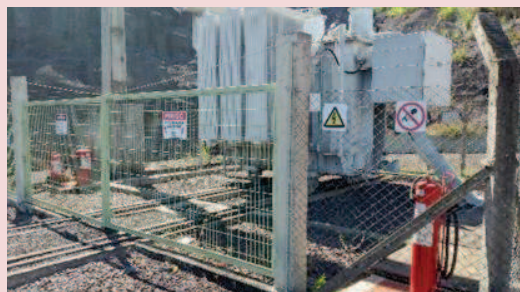
Foto 5-9. Disposição de extintores na área externa da casa de força da PCH Cantú 2.
