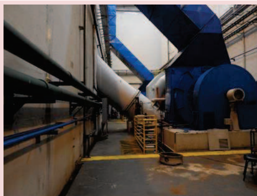
Foto 5-30. Vista das Unidades Geradoras (UG) da casa de força da PCH Cantú 2 organizadas.
