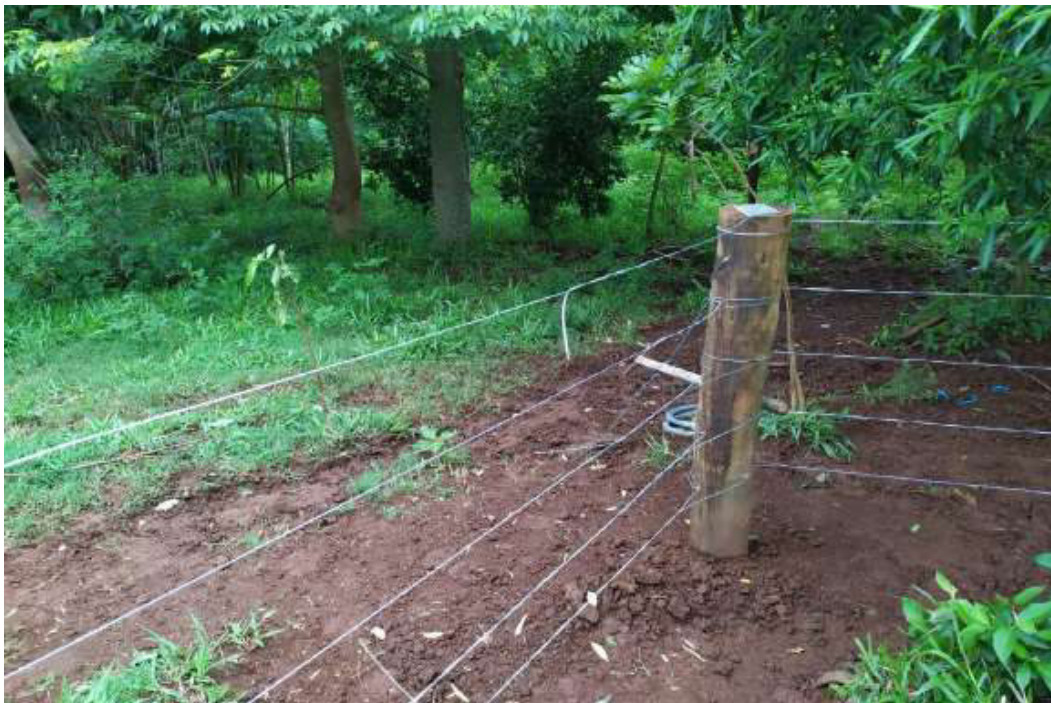
Figura 2.2.3.9 - Atividade de recuperação e colocação de cercamento na margem direita, na propriedade do Sr. Sebastião Galvão
