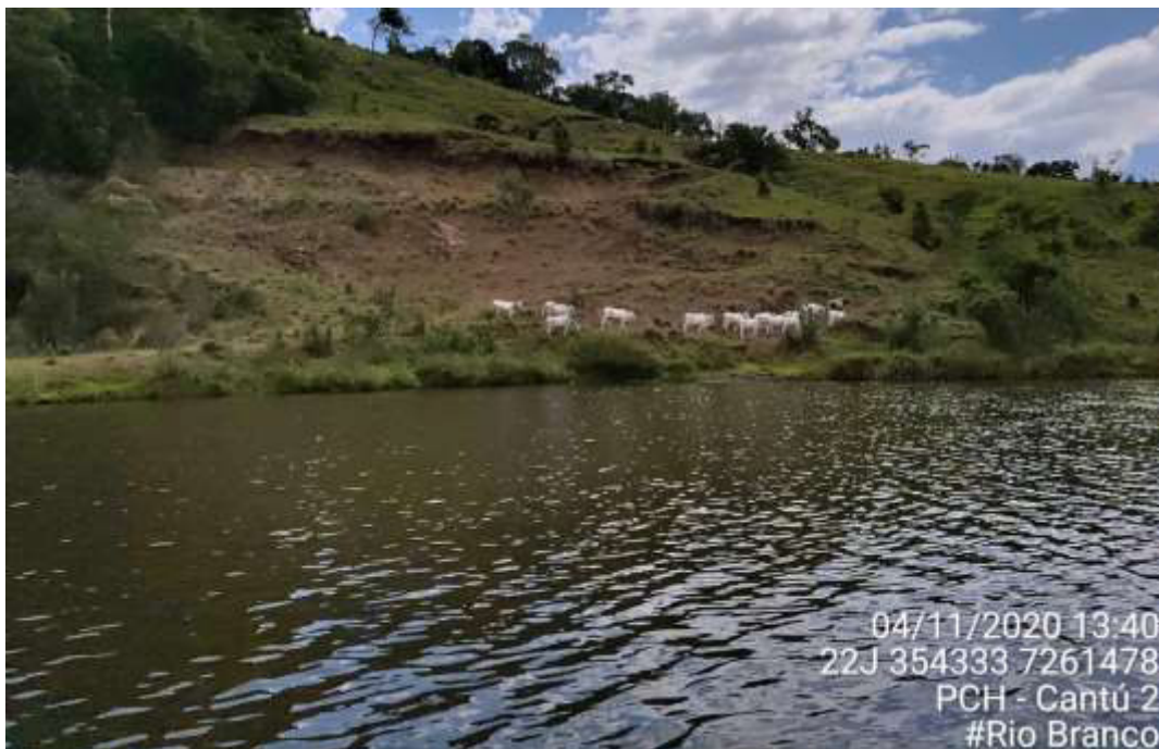
Figura 2.2.3.2 – Processo erosivo localizado na margem esquerda do reservatório artificial da PCH Cantu 2. Nota-se a presença de gado próximo a este.
