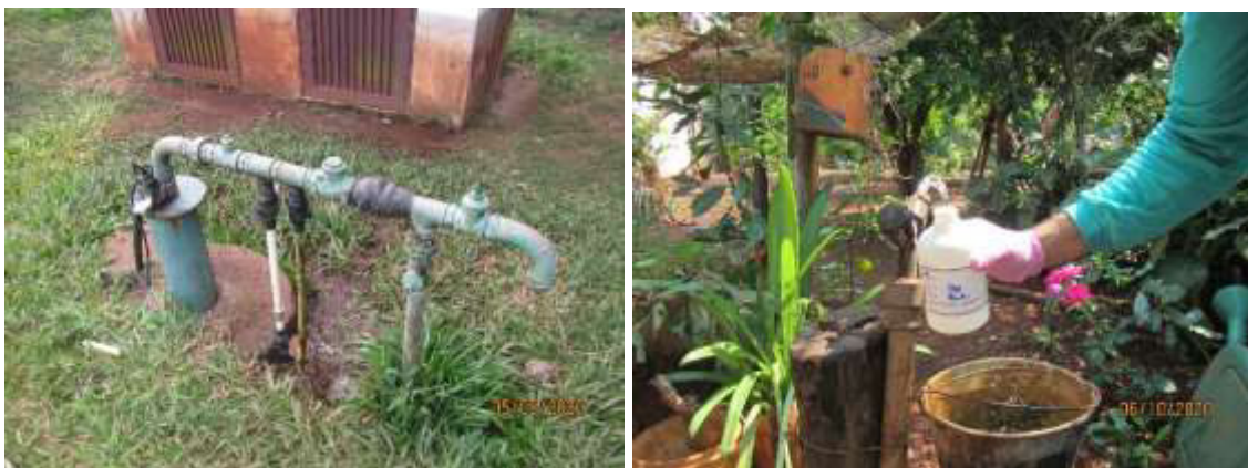
Figura 4.3.1.3 – Poço 03 no Assentamento Chapadão.
