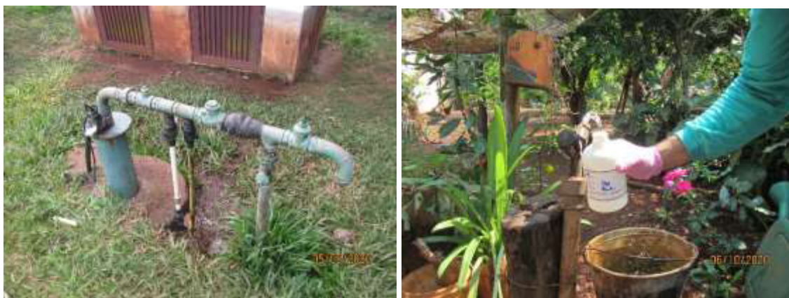
Figura 1.9 – Poço 03, no Assentamento Chapadão.
