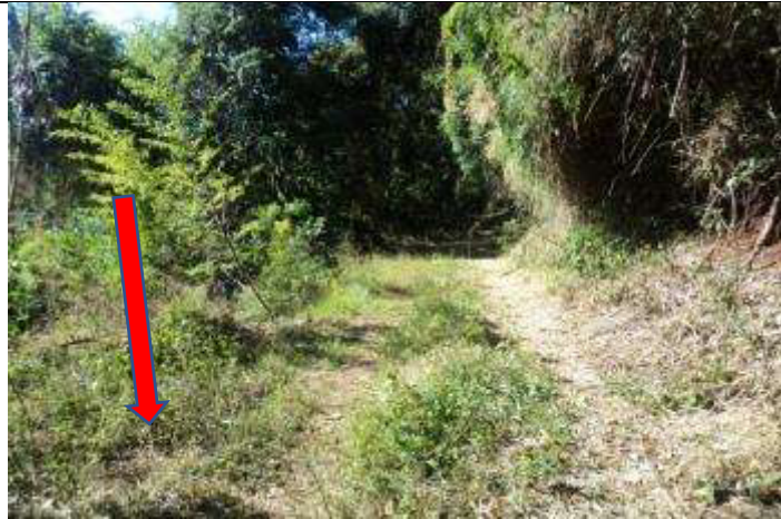
Figura 2.2.4.4 - Estrada utilizada por veículos e pessoas, paralela ao deslizamento de terra. Seta vermelha indicando o local de instabilidade.
