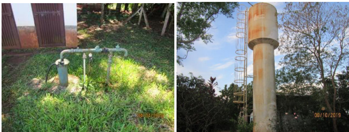
Figura 1.9 – Poço 03, no Assentamento Chapadão.
