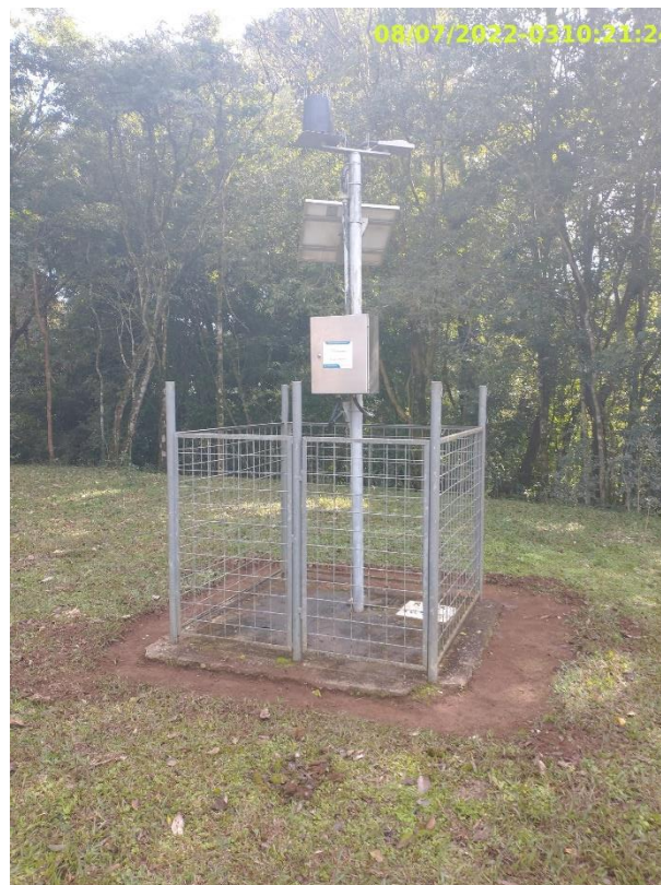
Estação Telemétrica Limpa (longe)
