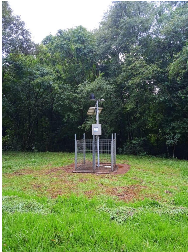
Estação Telemétrica Limpa (longe)
