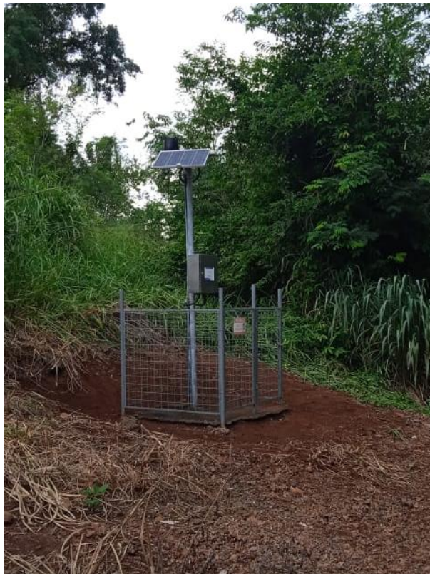
Estação Telemétrica Limpa (longe)
