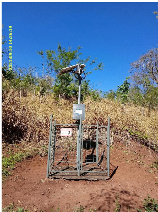
Estação Telemétrica Limpa (longe)
