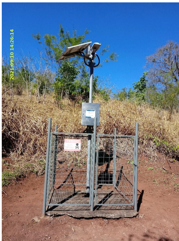
Estação Telemétrica Limpa (perto)
