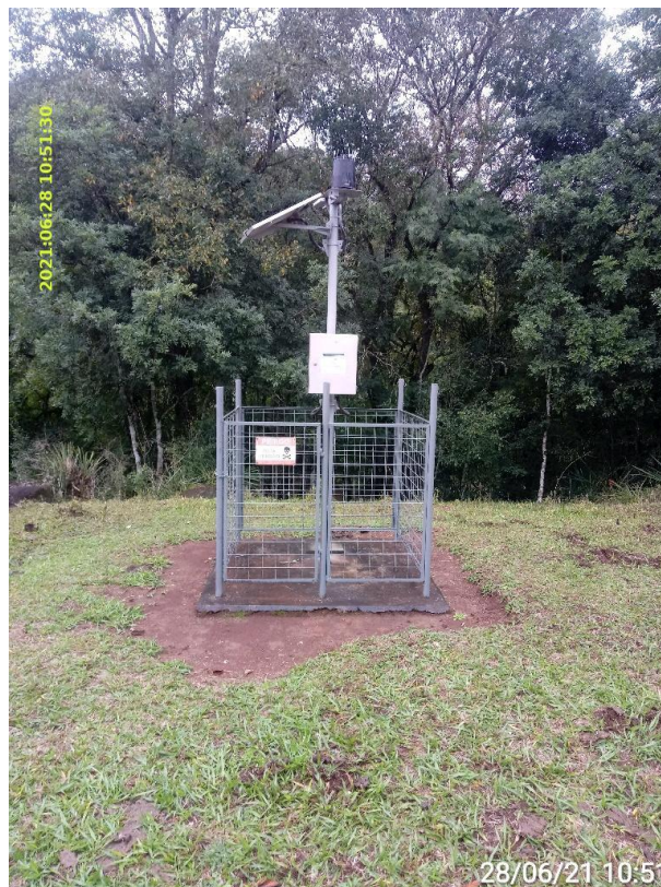
Estação Telemétrica Limpa (longe)
