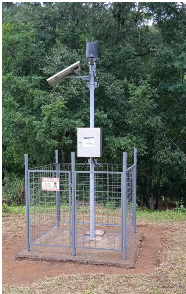
Estação Telemétrica Limpa (perto)
