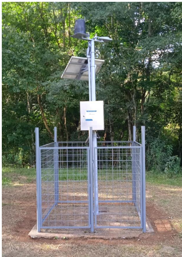
Estação Telemétrica Limpa (perto)
