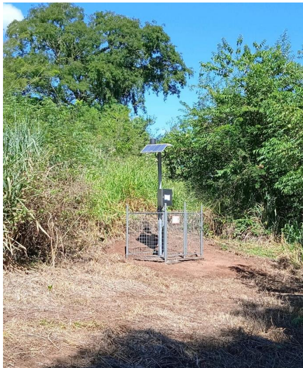
Estação Telemétrica Limpa (longe)
