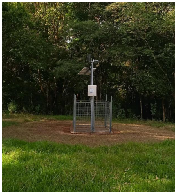
Estação Telemétrica Limpa (longe)
