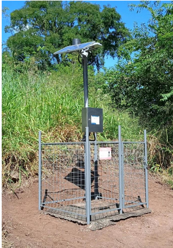
Estação Telemétrica Limpa (perto)
