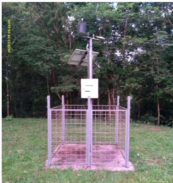
Estação Telemétrica Limpa (perto)
