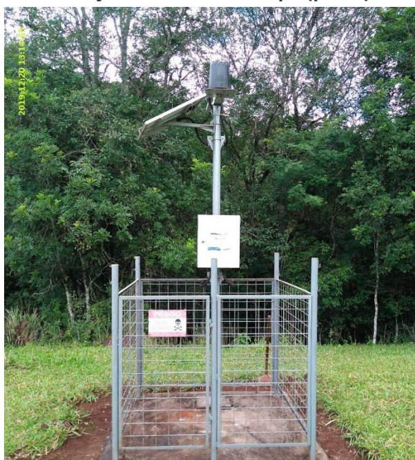
Estação Telemétrica Limpa (perto)
