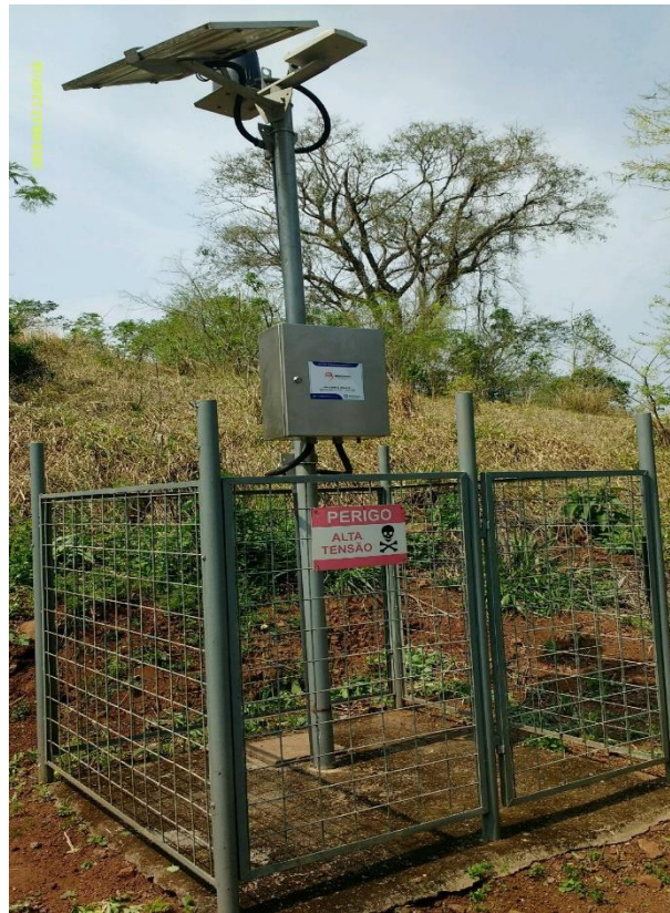
Estação Telemétrica Limpa (perto)
