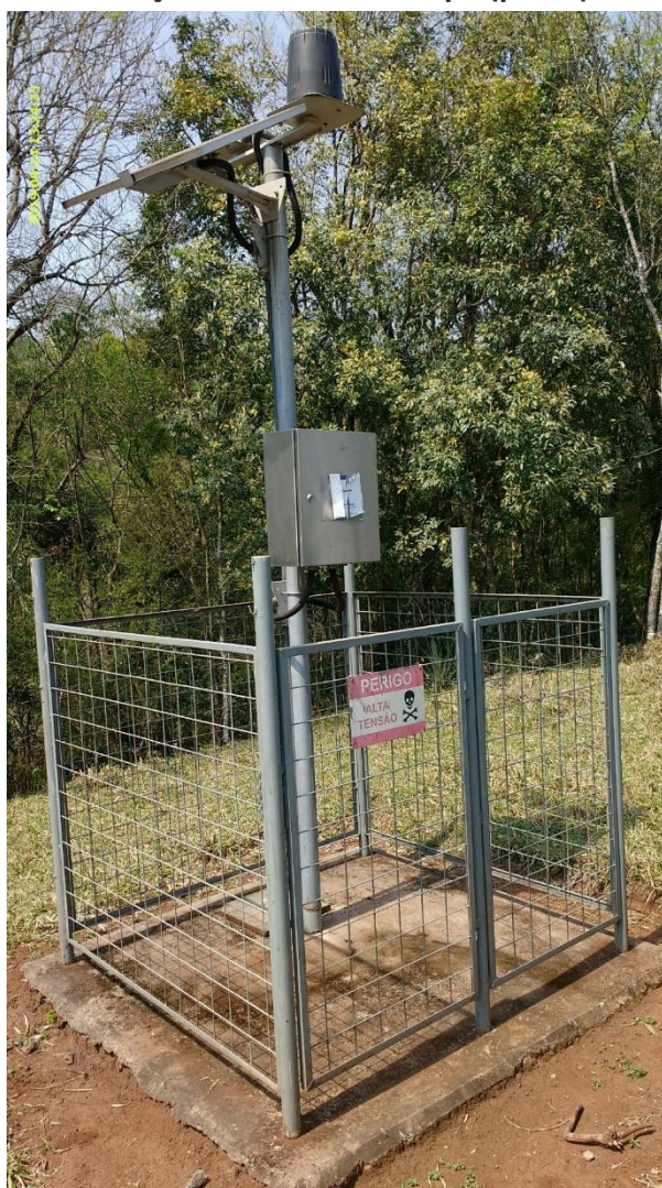
Estação Telemétrica Limpa (perto)
