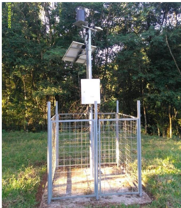
Estação Telemétrica Limpa (perto)
