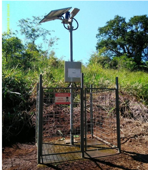
Estação Telemétrica Limpa (perto)
