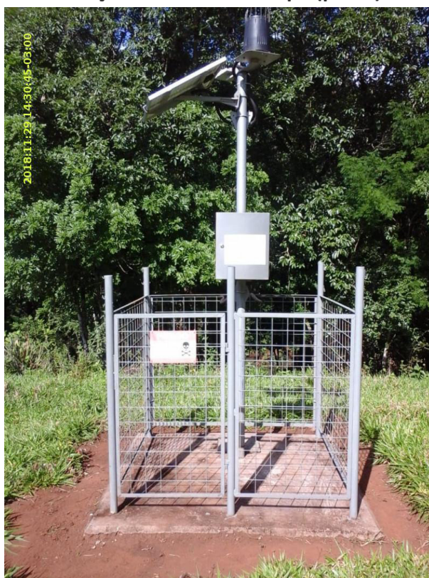
Estação Telemétrica Limpa (perto)
