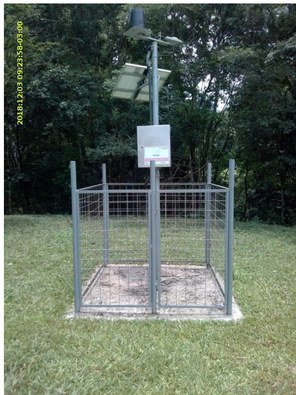
Estação Telemétrica Limpa (longe)
