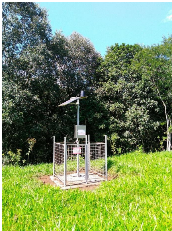
Estação Telemétrica Limpa (longe)
