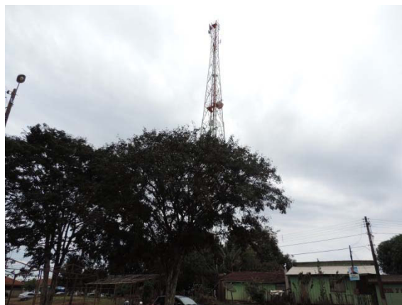
Figuras 6.1.3.3.8 - Antena de telecomunicações
