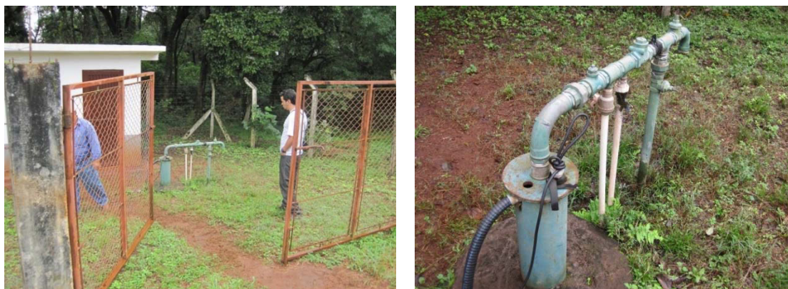
Figura 4.6.5.12 e 4.6.5.13 - Poço 03 no Assentamento Chapadão.
