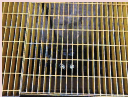
Foto 5-27. Vista interna da Caixa SAO na área interna da casa de força da PCH Cantú 2.
