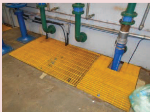
Foto 5-26. Grade com acesso para a caixa SAO na área interna da casa de força da PCH Cantú 2.
