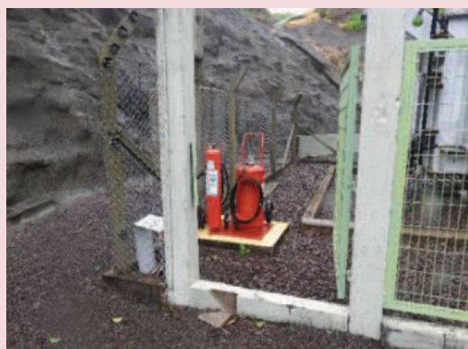
Foto 5-32. Disposição de extintores na área externa da casa de força da PCH Cantú 2.
