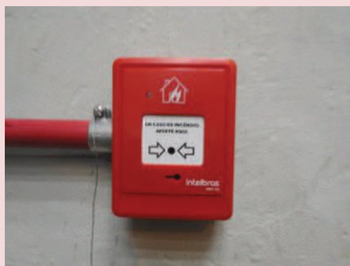
Foto 5-33. Sistema de alerta contra incêndio no interior da casa de força da PCH.
