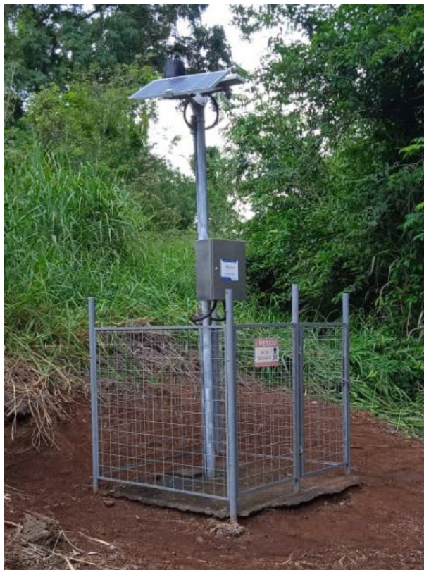
Estação Telemétrica Limpa (perto)
