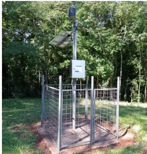
Estação Telemétrica Limpa (perto)
