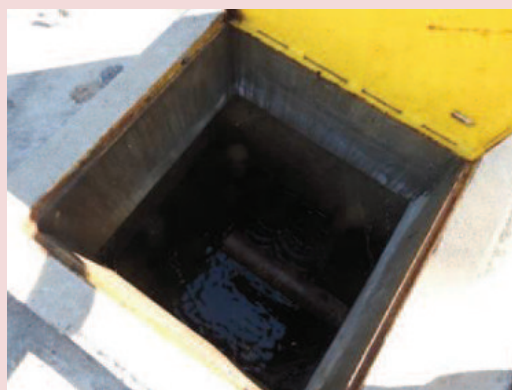
Foto 5-25. Vista interna da caixa SAO na área externa da PCH Cantú 2.
