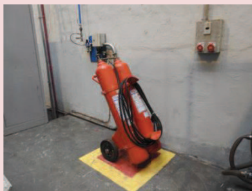
Foto 5-31. Disposição de um extintor na área interna da casa de força da PCH Cantú 2.
