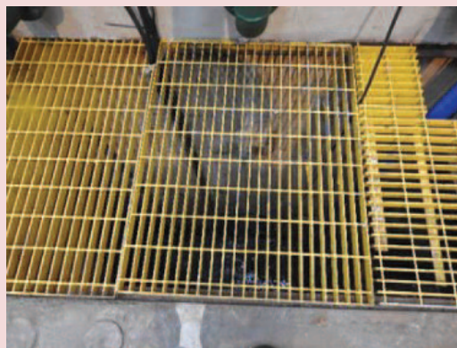
Foto 5-23. Grade com acesso para a caixa SAO na área interna da casa de força da PCH Cantú 2.
