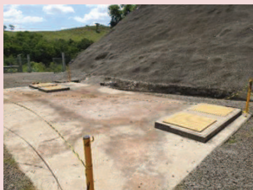
Foto 5-24. Sistema separador água e óleo (Caixa SAO) na área externa da casa de força da PCH Cantú 2.
