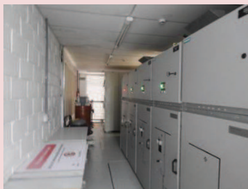
Foto 5-21. Vista da sala de controle da casa de força da PCH organizada.
