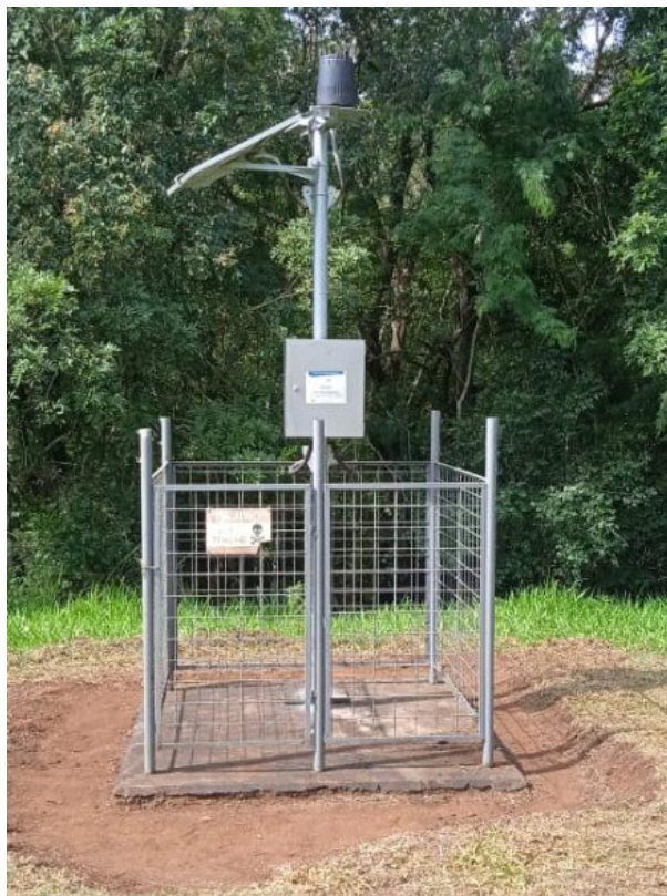
Estação Telemétrica Limpa (perto)
