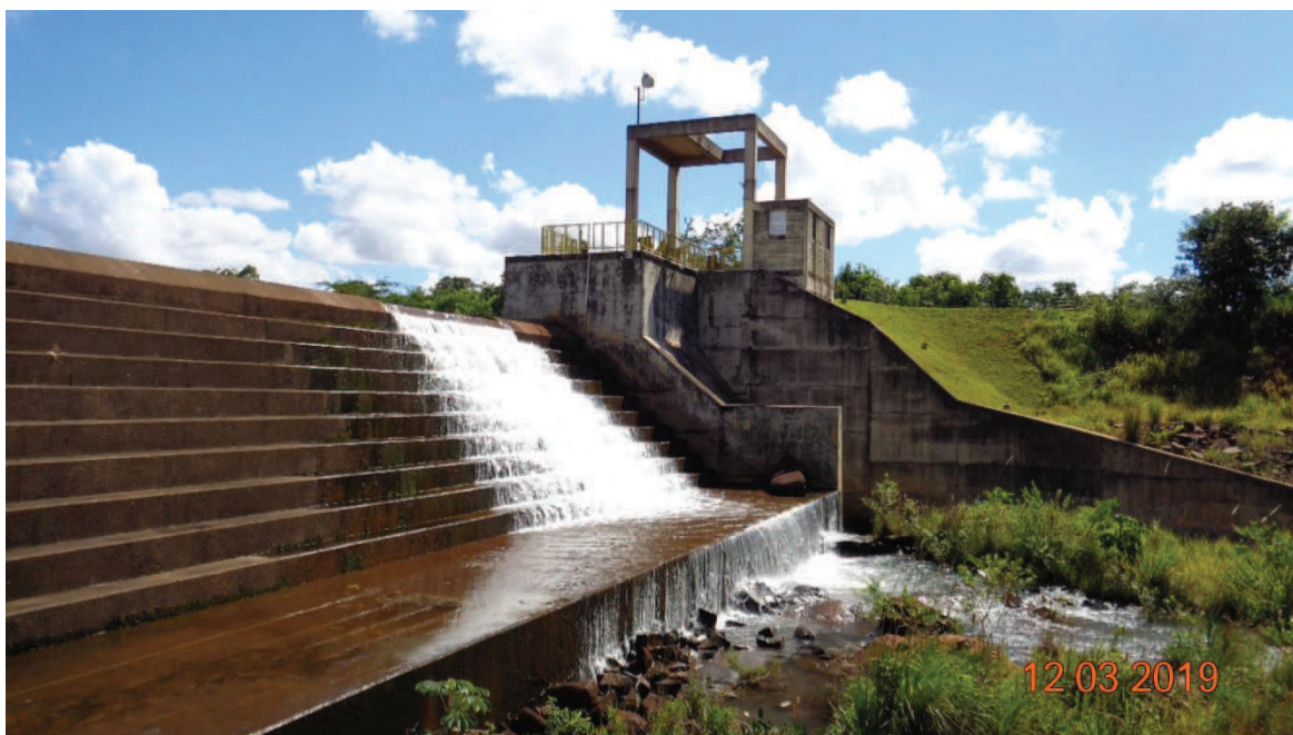
Figura 18 – Pórtico da tomada de água e sistema hidráulico de movimentação das comportas
