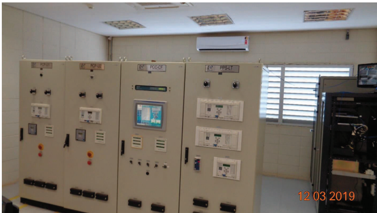
Figura 28 – Painéis de controle na Sala de comando
