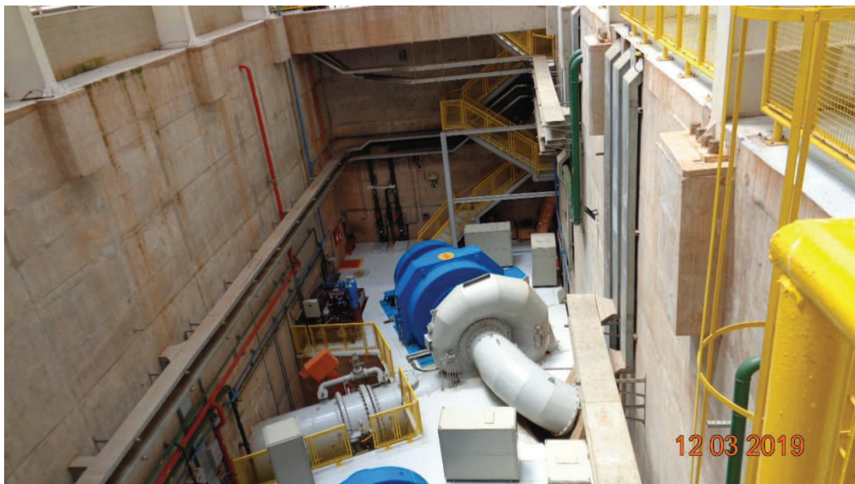
Figura 27 – Unidades geradoras e parede de jusante
