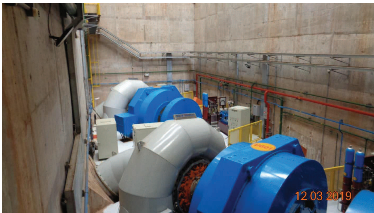
Figura 24 – Interior da casa de força no piso das unidades
