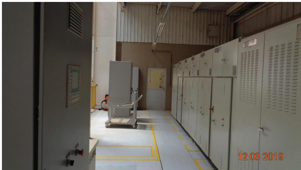
Figura 25 – Laje de painéis elétricos e da sala de comando
