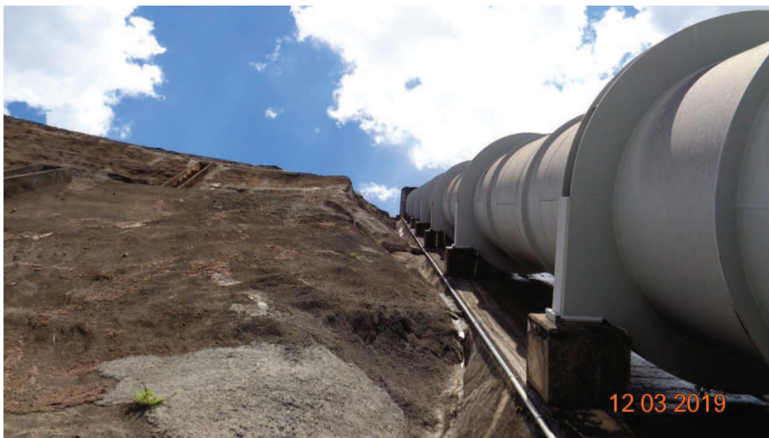
Figura 22 – Conduto Forçado e blocos de ancoragem
