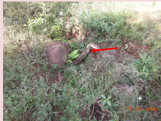
Foto 5-10. Vista parcial do interior da erosão do tipo sulco, evidenciando a ocupação da abertura por restolhos vegetais e detritos rochosos (seta).
