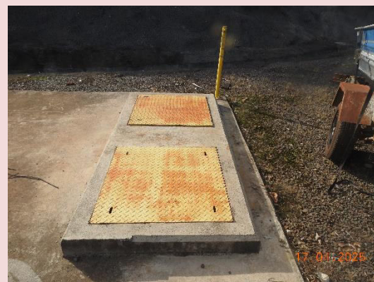
Foto 5-12. Sistema separador água e óleo (Caixa SAO) na área externa da casa de força.
