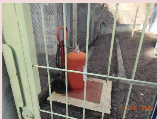
Foto 5-6. Disposição de um extintor na área externa da casa de força da PCH Cantú 2.
