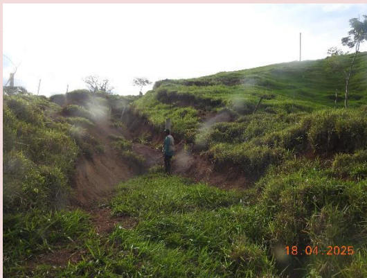
Foto 5-13. Vista aproximada do processo erosivo em estrada abandonada na margem direita do rio Cantú, evidenciando a profundidade da erosão. No centro da imagem, foto do consultor ambiental.
