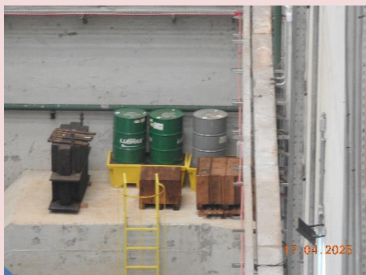
Foto 5-13. Vista de tambores de óleo em utilização, sobre bacia de contenção, no interior sala de operação da usina.
