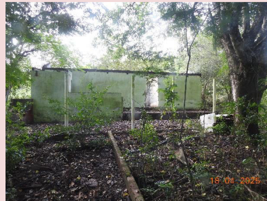
Foto 5-12. Vista geral da casa abandonada no Sítio Santa Rita, onde foi localizado um processo erosivo em curso.
