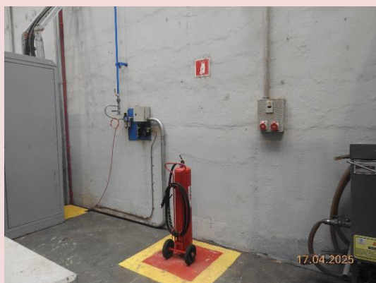
Foto 5-5. Disposição de extintores na área interna da casa de força da PCH Cantú 2.
