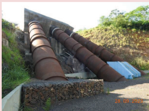
Foto 5-5. Vista do sistema externo da casa de força da PCH.
