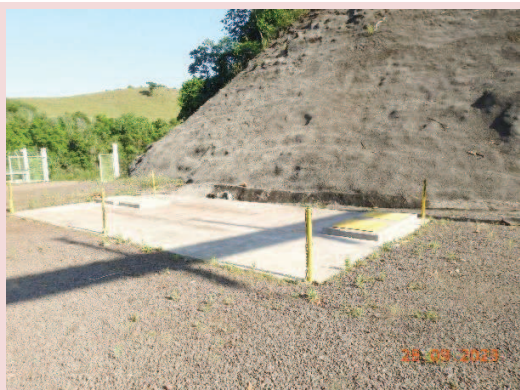
Foto 5-31. Sistema separador água e óleo (Caixa SAO) na área externa da casa de força da PCH Cantú 2.
