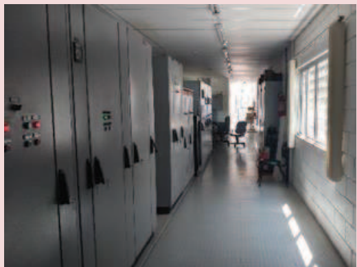
Foto 5-3. Vista geral da sala de comando da casa de força da PCH Cantú 2.
