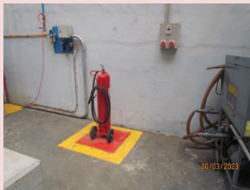
Foto 5-8. Disposição de um extintor na área interna da casa de força da PCH Cantú 2.
