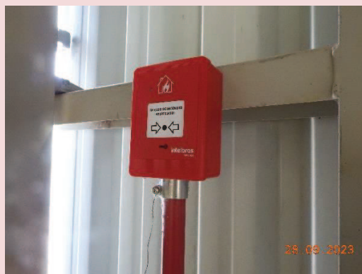
Foto 5-10. Sistema de alerta contra incêndio no interior da casa de força da PCH.
