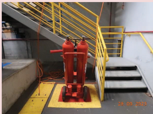
Foto 5-7. Disposição de extintores na área interna da casa de força da PCH Cantú 2.
