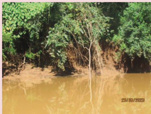
Foto 5-2. Vista de um trecho de APP com deslizamento de talude na M.D. do reservatório.
