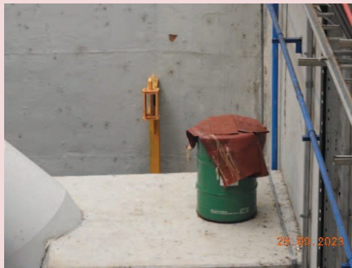
Foto 5-28. Vista das Unidades Geradoras (UG) da casa de força da PCH Cantú 2 organizadas.
