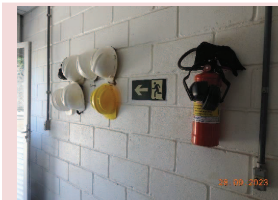
Foto 5-11. Disposição de EPIs (capacetes de segurança) e extintor na casa de Força da PCH.
