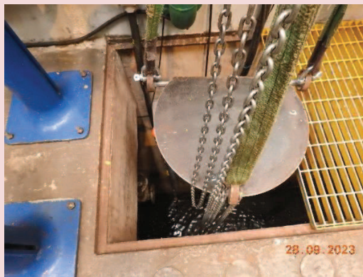
Foto 5-30. Sistema separador água e óleo (Caixa SAO) na área interna da casa de força da PCH.
