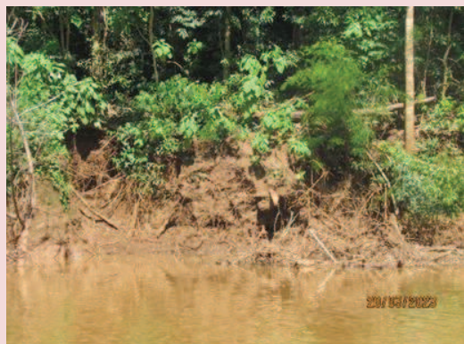
Foto 5-1. Vista de um trecho de APP com deslizamento de talude na M.E. do reservatório.
