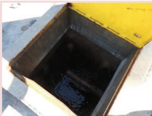
Foto 5-32. Vista interna da caixa SAO na área externa da PCH Cantú 2.
